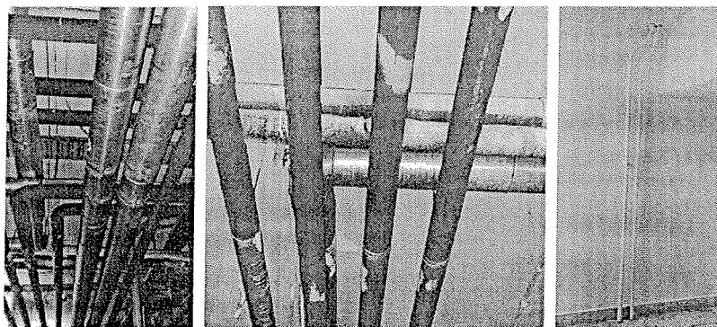
Slika 4: Dio cijevne mreže u toplotnoj podstanci (lijevo i u sredini) i dio cijevne mreže u objektu (desno)
