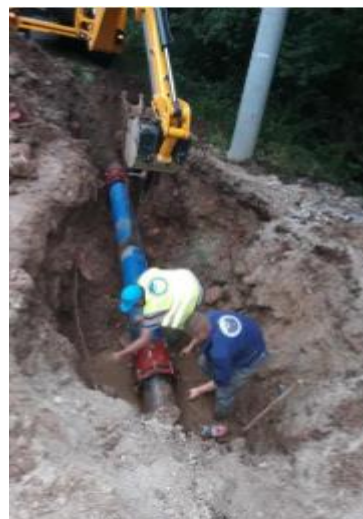
Slika 10. u ulici Baruthana br. 29 pukla je glavna vodovodna cijev DN 300. (24.06. 2021.g.,)
