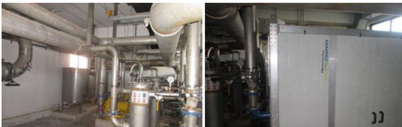
Slika 37: plinska kompresorska stanica – Izvor: terenska inspekcija nekretnine
