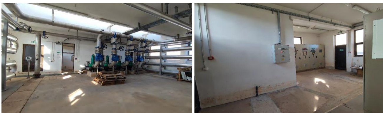
Slika 50: unutrašnjost kotlovnice – Izvor: terenska inspekcija nekretnine
