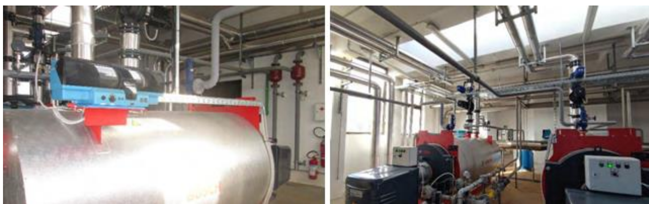
Slika 49: unutrašnjost kotlovnice – Izvor: terenska inspekcija nekretnine
