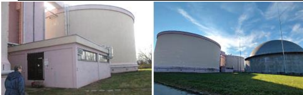
Slika 36: plinska kompresorska stanica – Izvor: terenska inspekcijanekretnine
