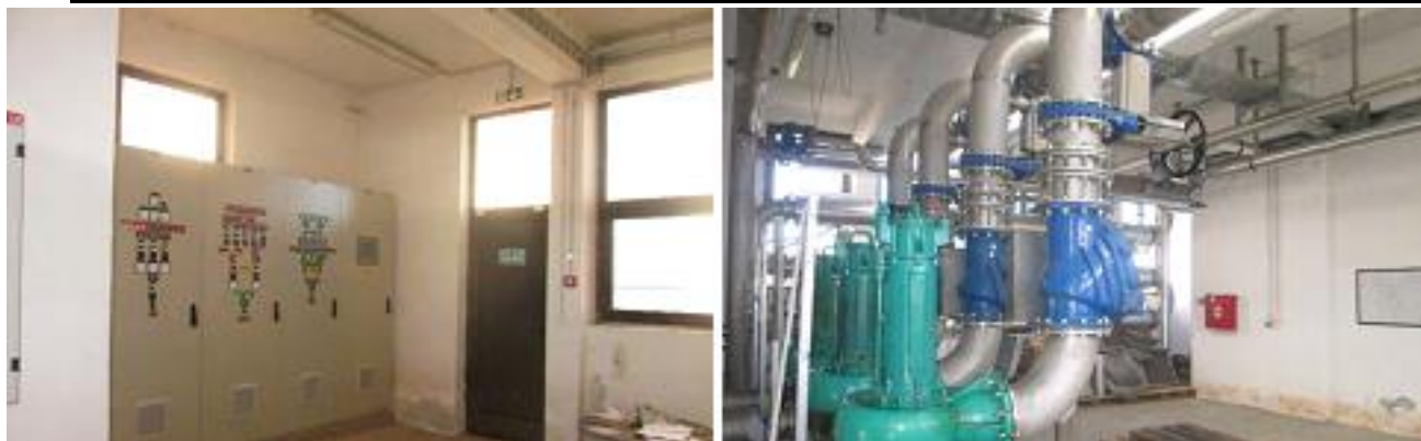
Slika 48: unutrašnjost kotlovnice – Izvor: terenska inspekcija nekretnine
