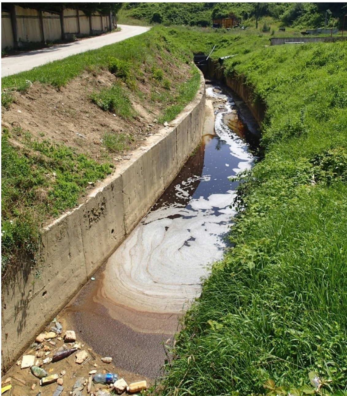
Slika 6 Deponija Sarajevo – netretirani ispust procjednih voda
